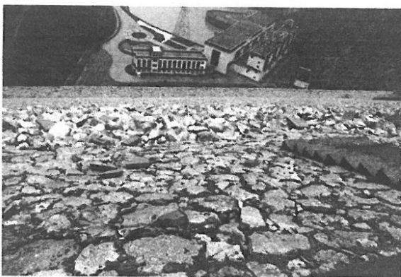
图6 紫坪铺大坝下游坡面砌石松动和翻起现象
